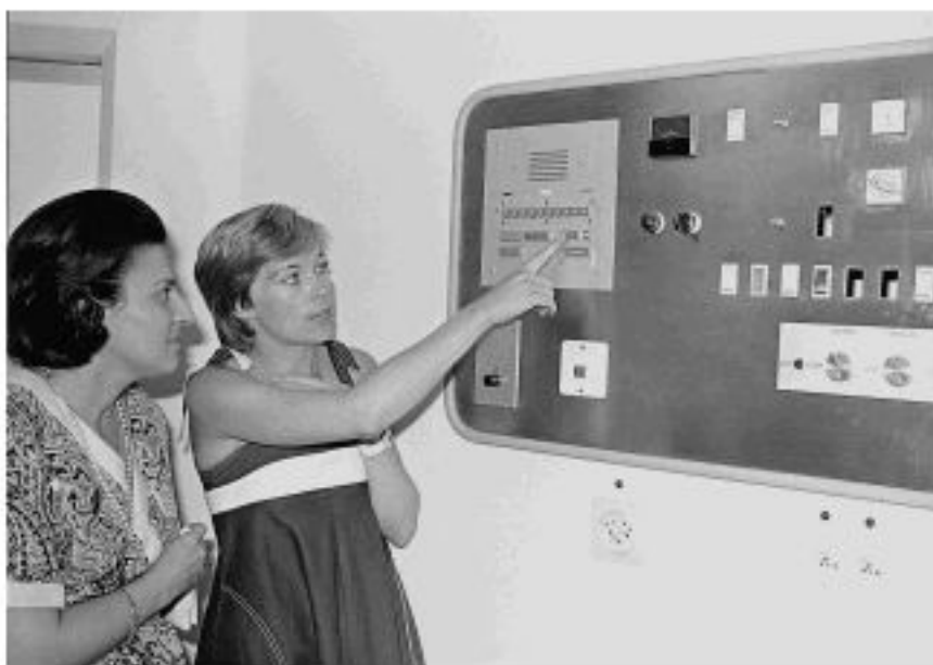
M me M. Henschoz, infirmière monitrice ayant assuré la programmation du quartier opératoire, montre à M me M. Zumofen le fonctionnement de l'interphonie et des divers contrôles tels qu'ils ont été installés sur le tableau des commandes techniques d'une salle d'opération.
