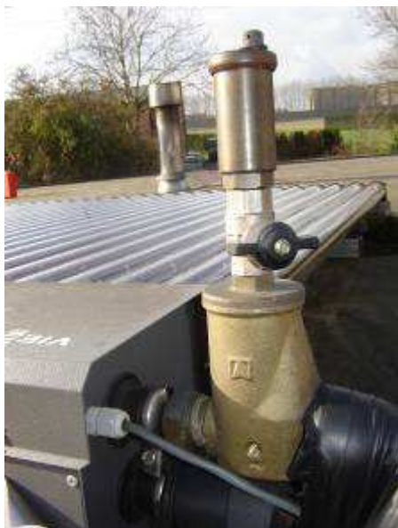
Photo 10 : Purgeur manuel au point haut du circuit primaire
