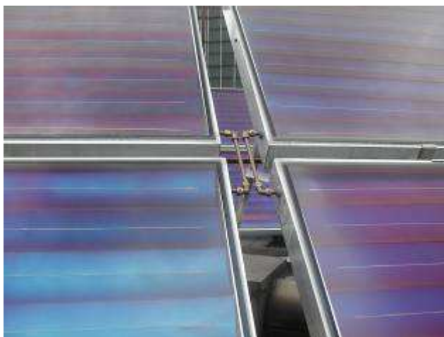
Photo 7 : Vue des capteurs atmosphériques plans vitrés
